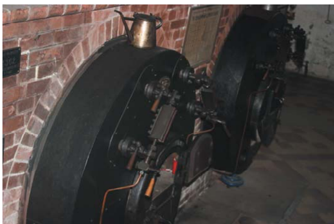
Původní funkční kotle
